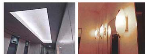
※サニックス博多ビルでのLED化実例
