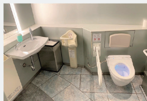
・節水型トイレの設置
